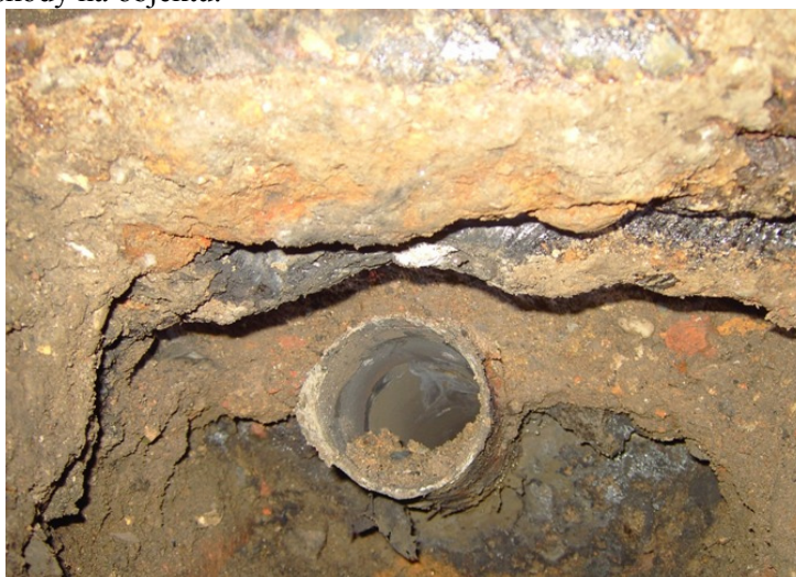
Obr. 11. Propálené potrubí DN 80 v důsledku kontaktu s elektrickým kabelem.
