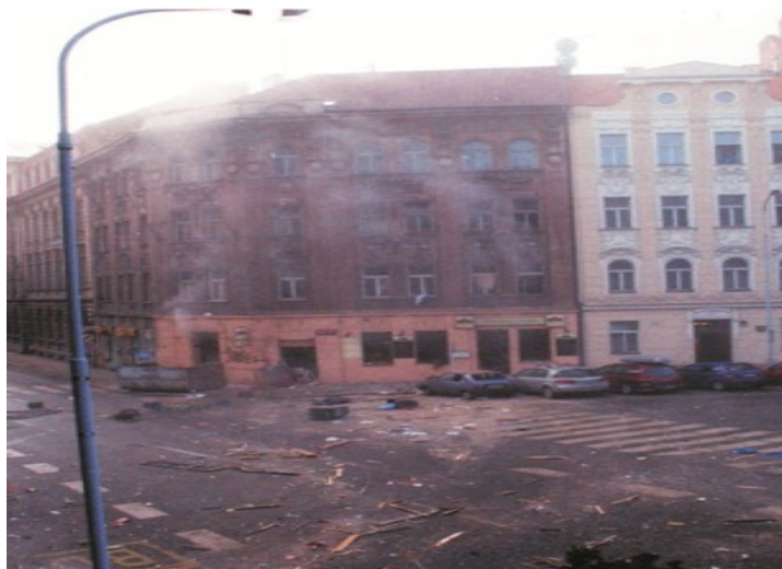
Obr. 10. Pohled na škody na objektu.
