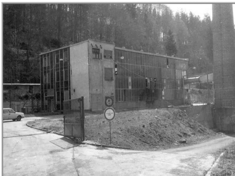
Obr. 4. Škody na budově kotelny.
